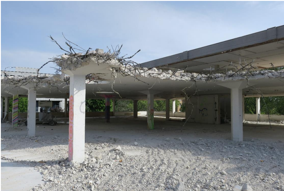
Le chantier nécessite une coordination entre démolition lourde et déconstruction - Source : Société Coopérative 2401
